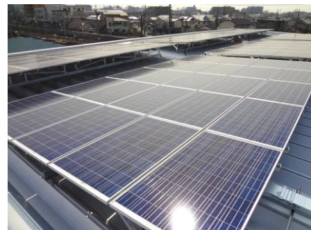
屋上に設置した太陽光発電システム(30kW)。発電された電力は再生可能エネルギー固定価格買取制度を利用して売電いたします。
