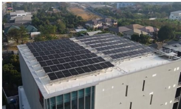
タイ新社屋の屋上に、太陽光発電による再生可能エネルギーを導入
