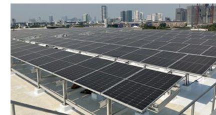
YUASA TRADING（THAILAND）CO.,LTD. 新本社の屋上に設置した太陽光発電設備。年間約50t-CO 2 の削減が見込まれる
