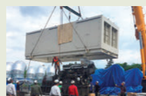
発電機防音カバー
