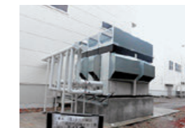
精密機器メーカーの工場へのチラー導入
