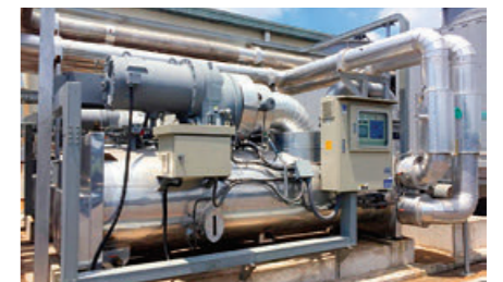
高効率ターボ冷凍機
