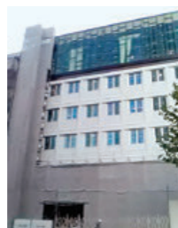
空調機器を納入した地方議会庁舎
