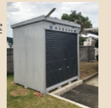
防災蓄電倉庫 設置事例
