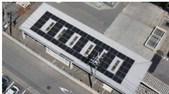
当社グループ会社の富士クオリティハウス（群馬県伊勢崎市）の敷地内 資材置き場屋根に太陽光パネル19.8kWを設置
