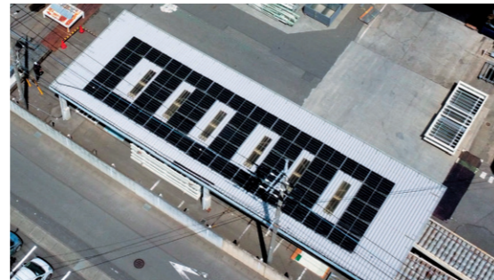
富士オリエティハウスの資材置き場屋根に設置した太陽光発電設備
