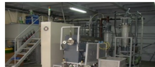
専焼型破壊設備の例 （フロンJCMによりR2年度にベトナムに導入済）
