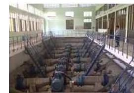
高効率ポンプ（ベトナム）
