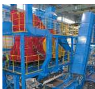
金属破碎・選別設備
