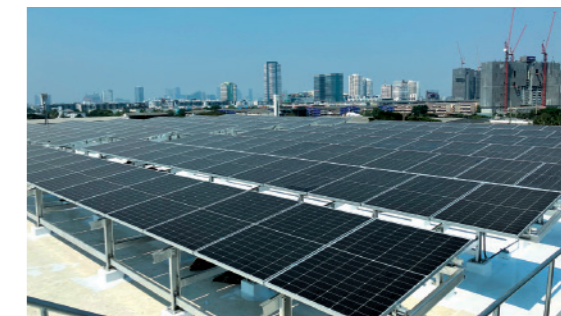
グループ会社 YUASA TRADING (THAILAND) CO.,LTD.新社屋の屋上に設置した太陽光発電設備
