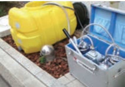
本社別館に設置した「レジリエンス井戸システム」。持ち運び可能な業界最小級の浄水システムを採用しています。
